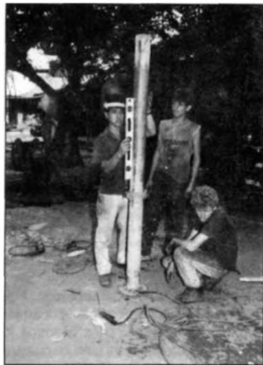
Fig. 24. En Industrias Surtidor se improvisó una base de armado de antenas en un piso bien nivelado, y el poste central se soldó a una platina circular previamente anclada en el piso.
